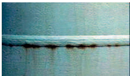
Fig. 6: corrosion intergranulaire dans la ZAT
